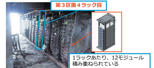
蓄電池設備の焼損状態 出典:経済産業省「電気設備自然災害等対策WG」資料(令和6年9月10日) ( https://www.meti.go.jp/shingikai/sankoshin/hoan_shohi/denryoku_anzen/denki_setsubi/pdf/021_03_00.pdf )
