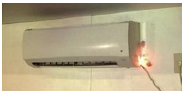
修理・改造されたエアコンの電源コードから発火する様子
