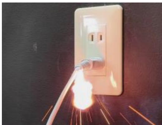
電源コードの半断線によるショート
