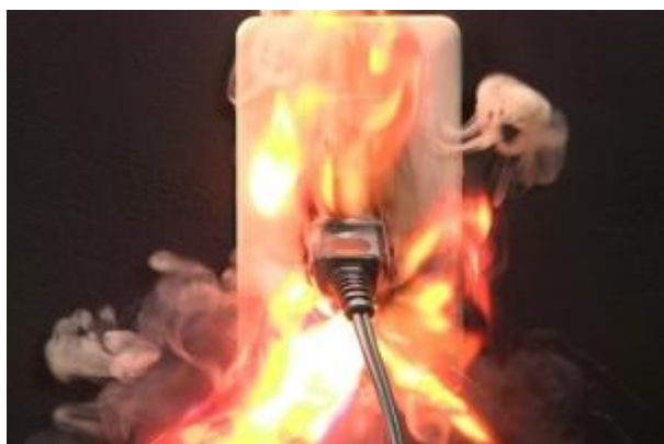
電源プラグ内部の破損による発火
