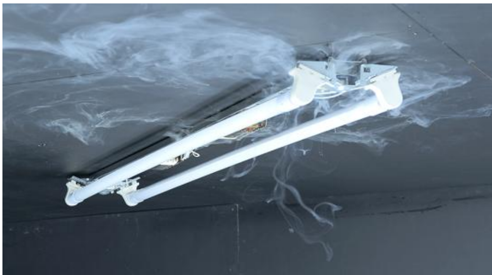
蛍光灯器具から発煙する様子（カバーを外した状態での再現実験）
