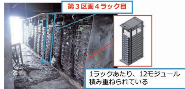
蓄電池設備の焼損状態 出典:経済産業省「電気設備自然災害等対策WG」資料(令和6年9月10日) https://www.meti.go.jp/shingikai/sankoshin/hoan_shohi/denryoku_anzen/denki_setsubi/pdf/021_03_00.pdf
