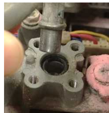
連結部 → Oリングを損傷
