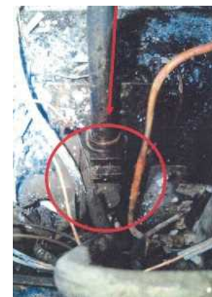
左バーナーガス配管接続部
