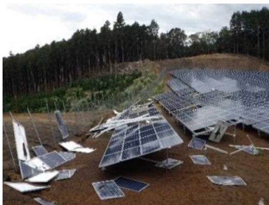
[図1] 台風時の強風による事故被害写真 出典：「電力安全小委員会の各WGにおける検討状況等について」（経済産業省 第22回産業構造審議会 保安・消費生活用製品安全分科会 電力安全小委員会）
