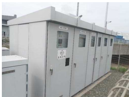
〔図1〕キュービクル(高圧受電設備)
