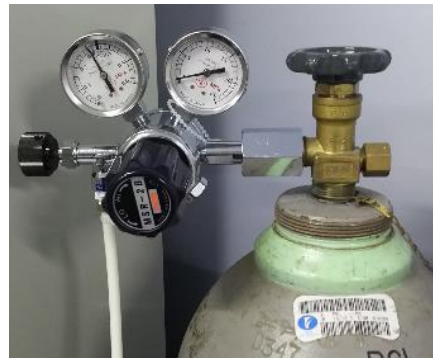
窒素ガスボンベ 圧力調整器
