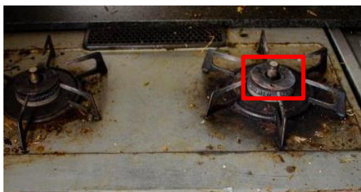
ごとく周辺の汚れを放置したガスこんろ
