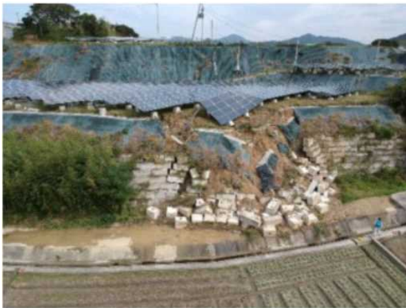
〔図1〕 台風の大雨による事故被害
