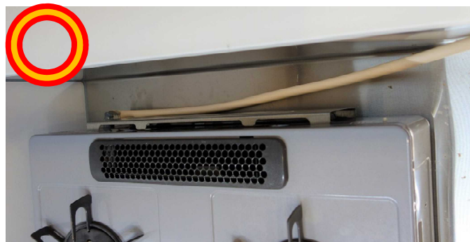
適切な配管の例
