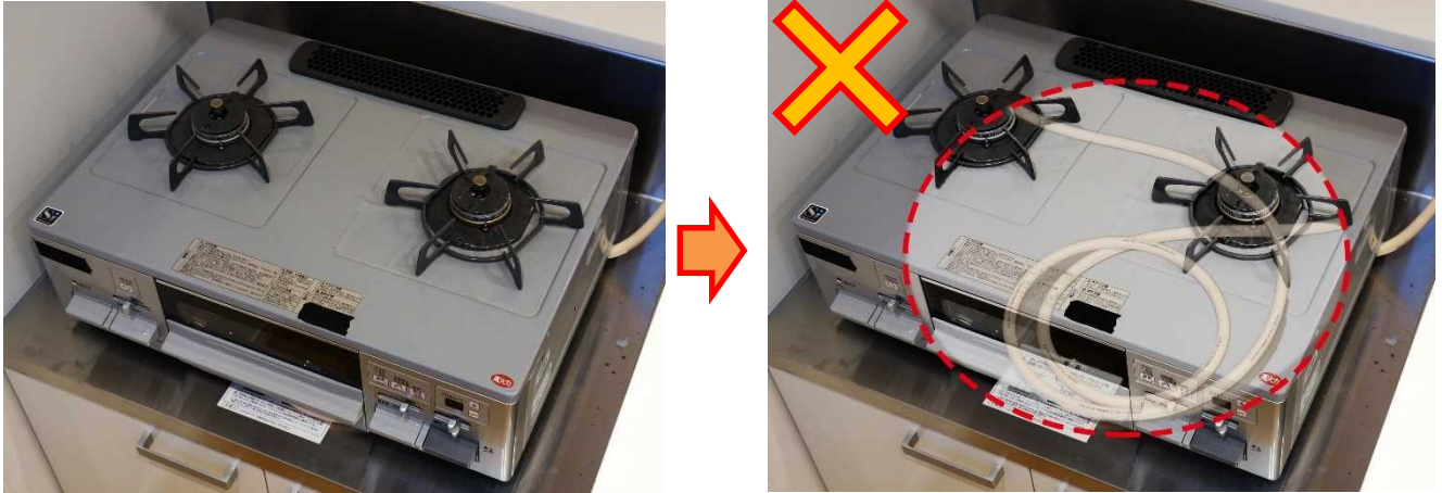
不適切な配管の例
