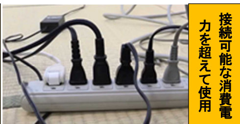
トラッキング現象による発火
