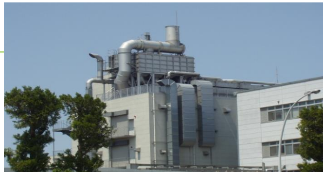
(写真2. VOC除害装置)
