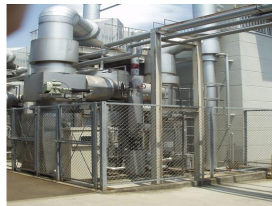
(写真10. 自家発電機)
