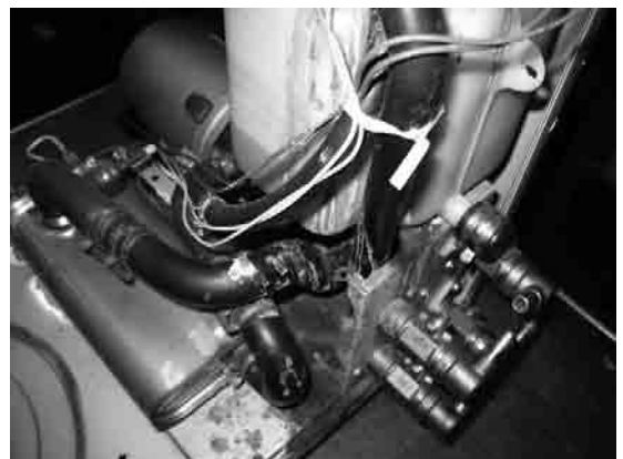
床暖熱交換機の不良による、循環用不凍液のもれ
